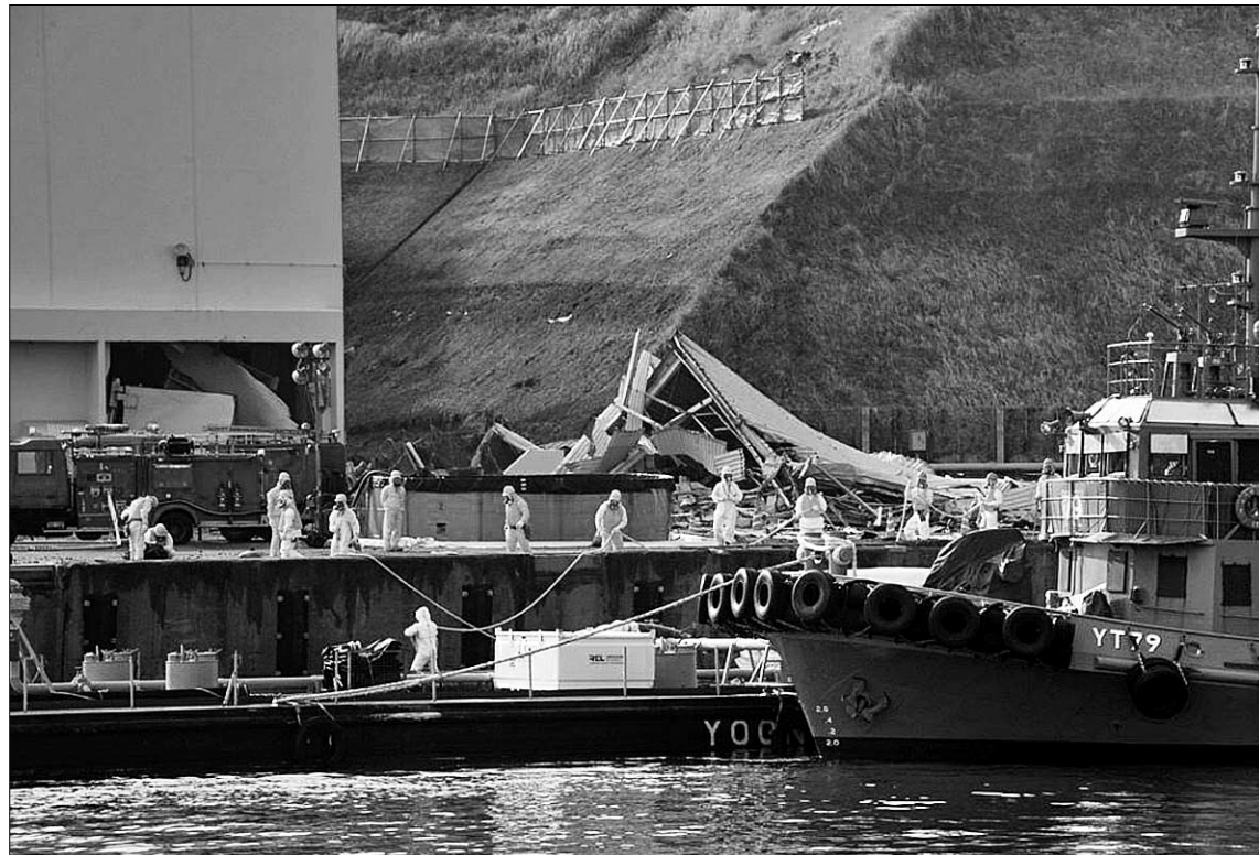
Los trabajos para contener los daños en la central nuclear continúan sin descanso. /EFE
